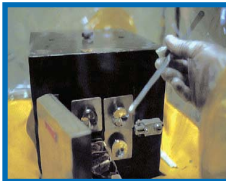
Figura 23: Extracción de las fuentes de radio de braquiterapia de la gamateca conteniendo las fuentes.
