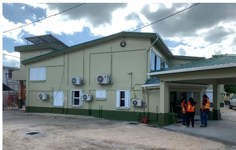
La polyclinique Cleopatra White a été équipée de panneaux solaires photovoltaïques, d'unités de climatisation à inverseur et de volets anti-tempête.
