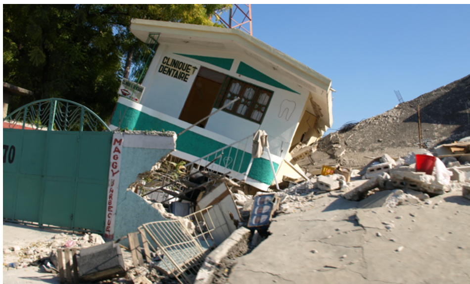
Clínica afectada. Terremoto. Haití 2010
