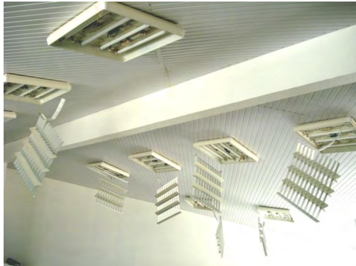
Figure 54 : Ici, les grilles-réfecteurs des éclairages au plafond ne possédaient pas de système de fixation approprié. Certaines sont tombées (Séisme du Nord-Martinique en 2007). (Cliché P. Balandier)
