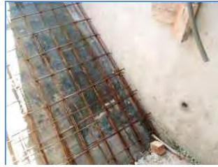
Figure 31 : Ces attentes scellées après coup par percement du béton ne sont pas correctement ancrées, les aciers ne seront pas en mesure de travailler correctement en traction. (Source ANCO)
