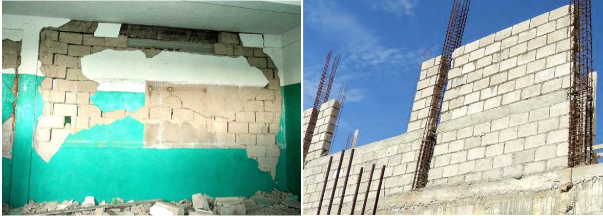
Figure 9 : A gauche, à Port-au-Prince, l'endommagement de l'enduit de la maçonnerie de remplissage d'un système poteaux-poutres (prohibé pour les établissements de santé) montre que les joints horizontaux ont été insuffisamment remplis et les joints verticaux pas du tout remplis.
