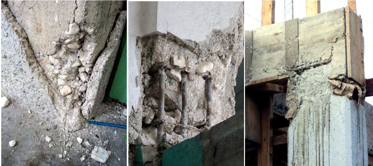
Figure 1 : A gauche, à Delmas 33, l'endommagement de l'enduit et du béton permet de constater la présence de galets de dimensions excessives et le manque de cohésion du béton par mauvais dosages.
