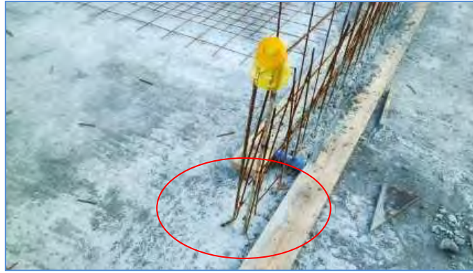
Figure 19 : Lors des efforts sismiques de traction, les aciers vont se remettre à la verticale avant d'assurer la résistance. (Source ANCO)
