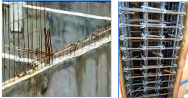
Figure 16 : A gauche, les attentes des chaînages verticaux sont trop courtes et ne permettront pas un recouvrement garantissant la continuité de la transmission des efforts en situation sismique. (Source ANCO)
