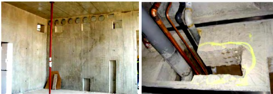
Figure 28 : Percement d'un mur après réalisation réduisant de façon inacceptable la capacité portante du voile. (Source ANCO)
