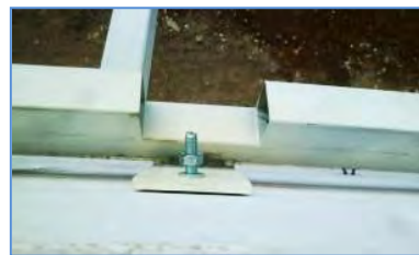
Figure 38 : Le serrage d'un boulon mis en place peut être oublié. Les vérifications doivent être faites avec méthode. (Source ANCO)
