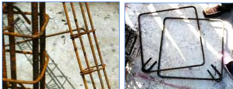
Figure 18 : A gauche, cadres incorrectement fermés. (Source ANCO). A droite, mise en œuvre correcte : chantier exemplaire à Pétion-ville en 2011. (cliché Balandier)
