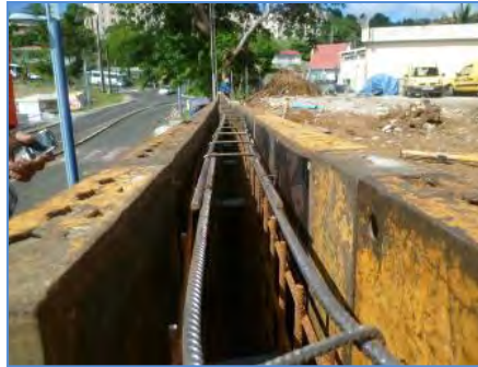
Figure 12 : Les aciers des murs de soutènement sont souvent mal positionnés en particulier les aciers travaillant en traction côté terre. (Source ANCO)
