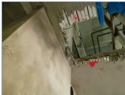
Figure 26 : Cette trémie improvisée supprime les aciers et le béton permettant la transmission des efforts de la dalle aux éléments de contreventement. (Source ANCO)
