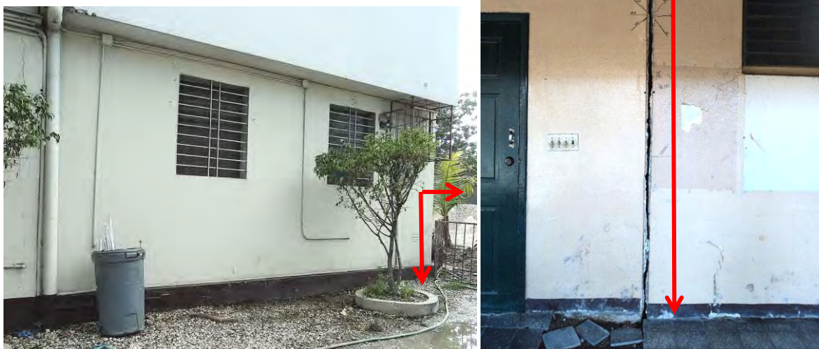
Figure 29 : Liquéfaction modérée, mais qui a imposé l'évacuation de plusieurs bâtiments légèrement basculés dans un centre de soins à Port-au-Prince, suite au séisme du 12 janvier 2010. (Clichés P. Balandier)
