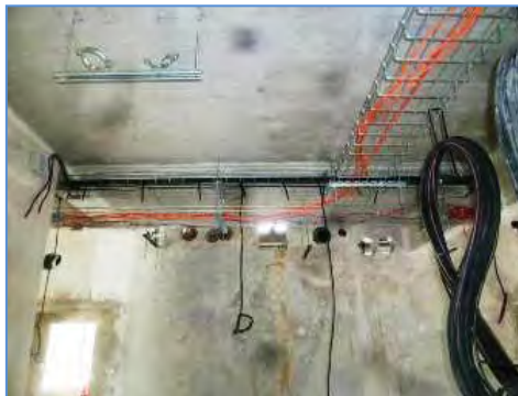
Figure 20 : Il est interdit de réaliser des percements a posteriori dans les voiles de contreventement. (Source ANCO)
