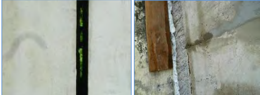
Figure 10 : A gauche, la largeur d'un joint de dilatation parasismique doit être calculée, et respecter un minimum de 6 cm. (Source ANCO)
