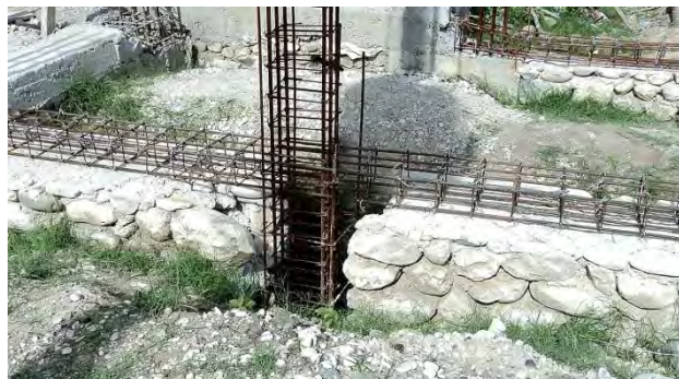
Figure 12 : La maçonnerie de pierre en soubassement, fréquemment pratiquée en Haïti (ici à Tabarre), est prohibée pour les établissements hospitaliers dont les fondations, et les murs périphériques aux vides sanitaires, doivent être en béton armé pour prévenir toute déformation significative. (Cliché P. Balandier)
