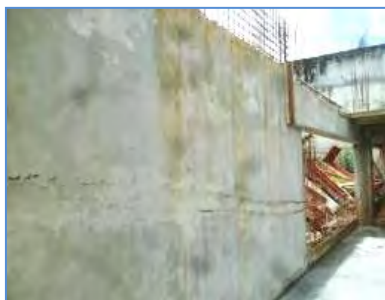
Figure 23 : Les reprises de bétonnage réalisées n'importe où et en particulier en diagonale, sont des amorces de fissures. (Source ANCO)
