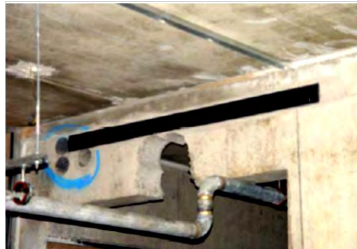
Figure 30 : Aciers principaux de poutre coupés. (Source ANCO)
