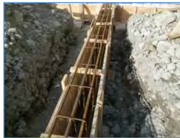
Figure 9 : Exemple de butée de radier coffrée. Après décoffrage les vides latéraux seront remplis de remblai n'ayant pas suffisamment de résistance horizontale pendant un séisme. (Source ANCO)
