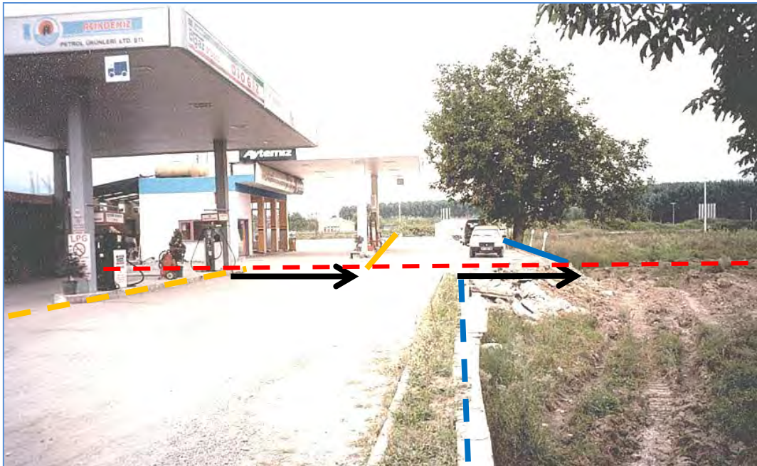
Figure 19 : « Décrochement » dans une station-service lors du séisme d'Izmit (Turquie) en août 1999.
