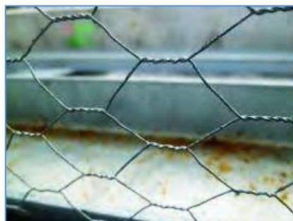
Figure 39 : Corrosion de limaille sur un profilé horizontal mal nettoyé et non protégé. (Source ANCO)
