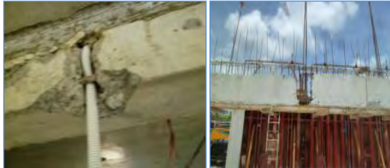
Figure 24 : A gauche : Endommagement volontaire d'une poutre inacceptable... et irréparable. (Source ANCO)
