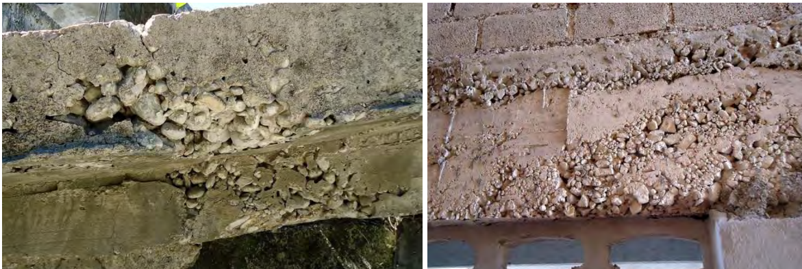
Figure 4 : A gauche, aux Cayes, à une centaine de kilomètres de l'épicentre, le béton d'un bâtiment qui s'est effondré, constitué de gros galets peu liaisonnés, illustre une pratique délictueuse inacceptable.
