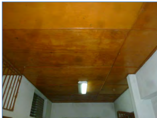
Figure 60 : Exemple de faux plafond en matériau propagateur de flammes ; Interdit. (Source ANCO)
