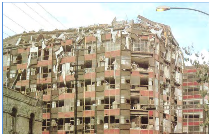
Figure 23 : Le phénomène de résonance a été remarquablement illustré à Mexico en 1985. La ville implantée à près de 400 km de l'épicentre, dans une cuvette sur 50 m de sols limoneux de faible consistance, a très fortement amplifié les oscillations d'une période de 2 s. Les immeubles dont une période propre d'oscillation était proche de celle du site se sont mis en résonance et se sont effondrés. Sur le cliché ci-dessus un bâtiment (au centre) entré en résonance est très endommagé. La petite maison en pierres (à gauche) et l'immeuble ressemblant (à droite), qui n'avaient pas plus de résistance, n'ont pas de dommages apparents. (Document NISEE)
