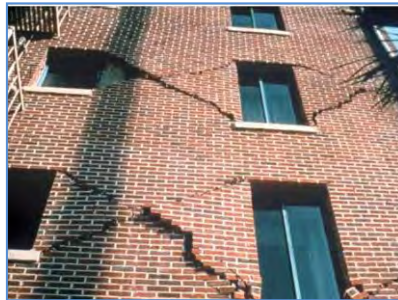
Figure 35 : Exemple de rupture inacceptable d'une maçonnerie de façade suite à un séisme. (Source non identifiée)
