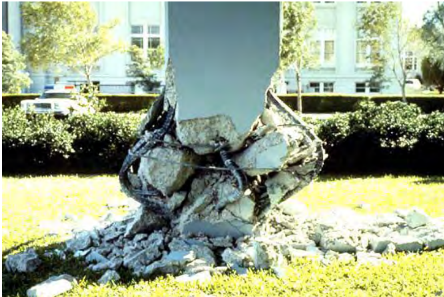
Figure 44 : Exemple de rupture fragile: le pied de poteau a "explosé". Dans ce cas l'immeuble n'est pas effondré car des reports de charges ont pu se faire sur d'autres éléments porteurs non endommagés. (Cliché Godden – NISEE)
