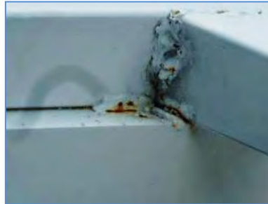
Figure 37 : Corrosion en cours de développement au départ d'une soudure mal réalisée. (Source ANCO)
