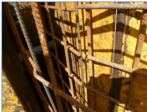
Figure 13 : Les nappes d'acier simplement pliées pour marquer l'angle vont avoir tendance à se redresser (poussée au vide) et entraîner l'éclatement du béton. (Source ANCO)
