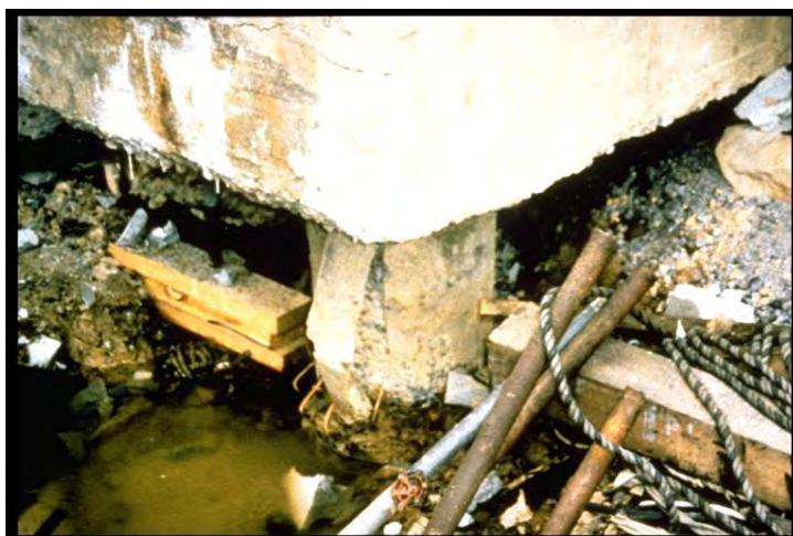
Figure 26 : Pieu dénudé sous l'effet d'un phénomène de liquéfaction. A hauteur du niveau d'eau on voit que les aciers longitudinaux ont flambé sous l'effet d'un effort en compression (Séisme de Kobé, 1995). (Document EQIIS USA)
