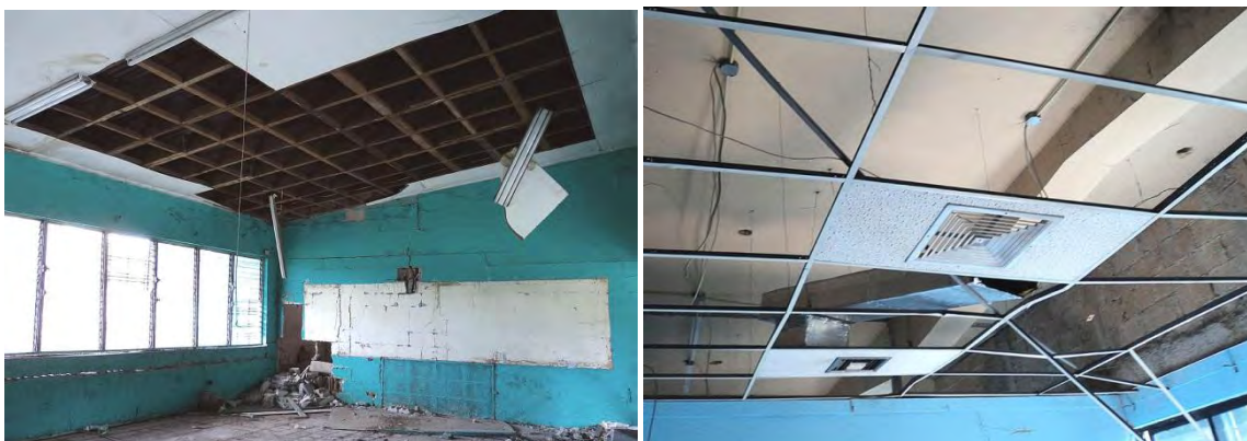
Figure 37 : A gauche, à Port-au-Prince, salle de formation d'un centre de soins, le plafond de plaques sous châssis en bois est tombé le 12 janvier 2010. (Cliché P. Balandier)
