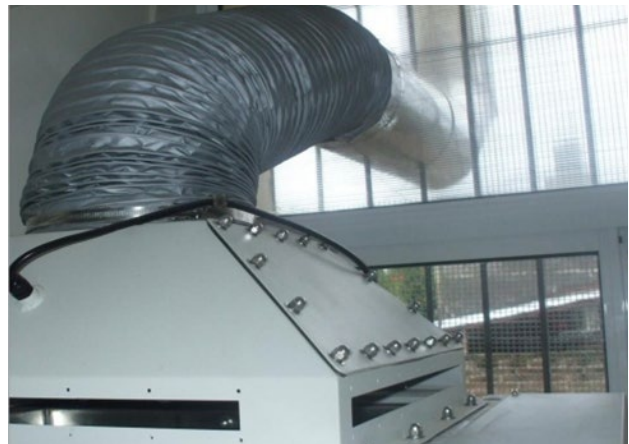
Ducto conectado en dedal sobre la cabina de seguridad biológica Clase II tipo A que genera presión negativa
