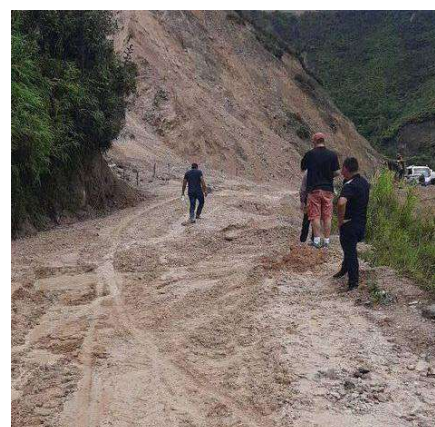
FOTO 4: Vía afectada Onzaga – El Heraldo
